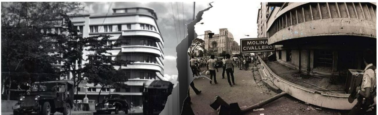
Fig. 78 Antes y después del terremoto de 1986 en el edificio Dueñas. (Nuestros Edificios. 2013)
