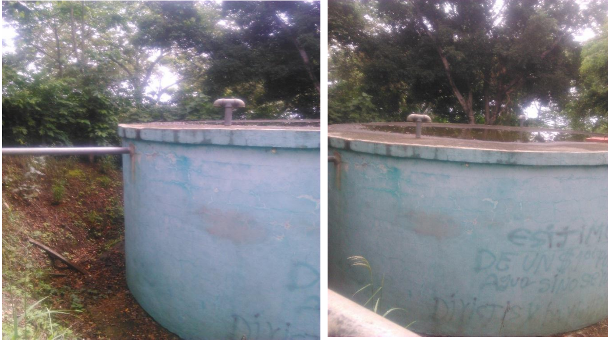
Fotos de tanque dañado
