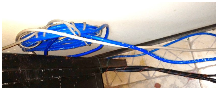
Figura 48. Cables de red con una longitud excesiva que están enrollados y colgados del techo.
