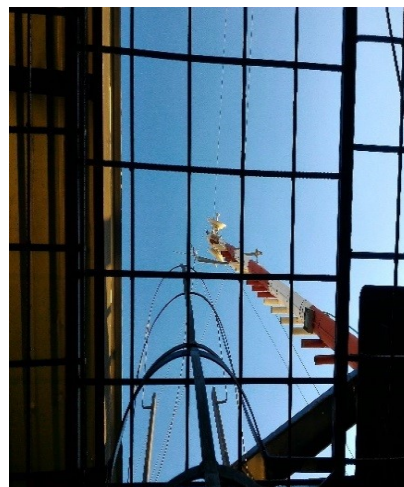
Figura 38. Mástil con antenas ubicado en Unidad Central que conectan vía radio frecuencias el internet movistar al Parque Ecoturístico Tehuacán y el Distrito San Nicolás Lempa.
