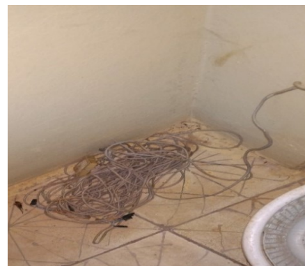
Figura 43. Exceso de cable en sala de reuniones del Concejo Municipal.
