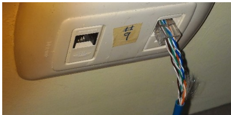
Figura 49. Cables UTP con los pares trenzados internos expuestos, conector RJ45 mal armado.
