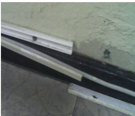
Figura 40. Cañuela en mal estado en la oficina de contabilidad.
