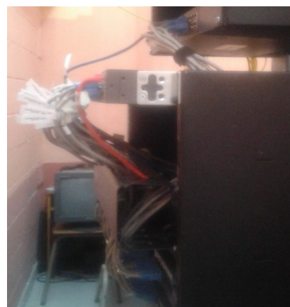
Figura 71. Switch de Unidad Casa Comunal, después del etiquetado.
