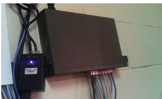
Figura 27. Switch de 16 puertos del Distrito San Nicolás Lempa.
