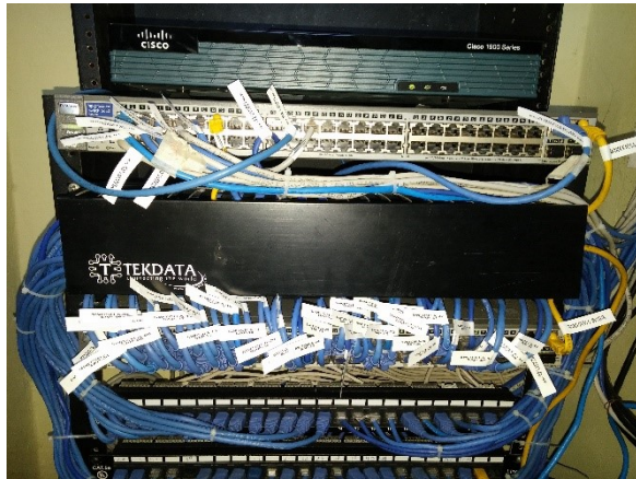
Figura 67. Switch de la Unidad Central, después del etiquetado.
