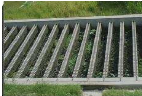
Figura 6.36 Filtro percolador pequeño.
