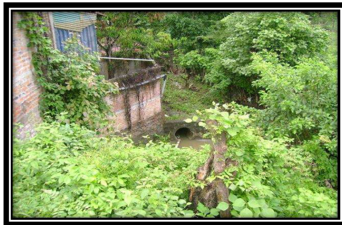
Figura 1.2 Descarga de aguas negras sobre la quebrada La Ceiba
