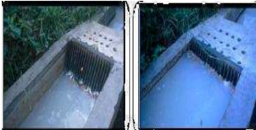
Figura 6.31 Canal de rejillas con obstrucción.
