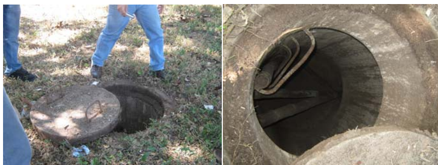
Fotografías 9 y 10: Pozo de visita de sistema de agua potable, y tuberías en mal estado
