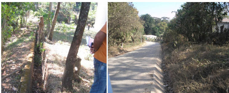
Fotografías 7 y 8: Sistema de drenaje de aguas lluvias existente
