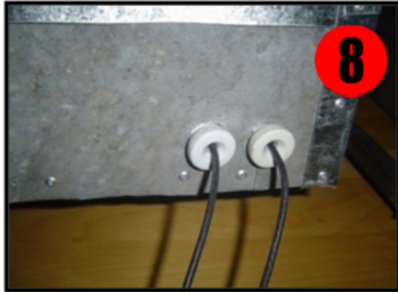
Img. 25 Aisladores colocados en la caja de horno
