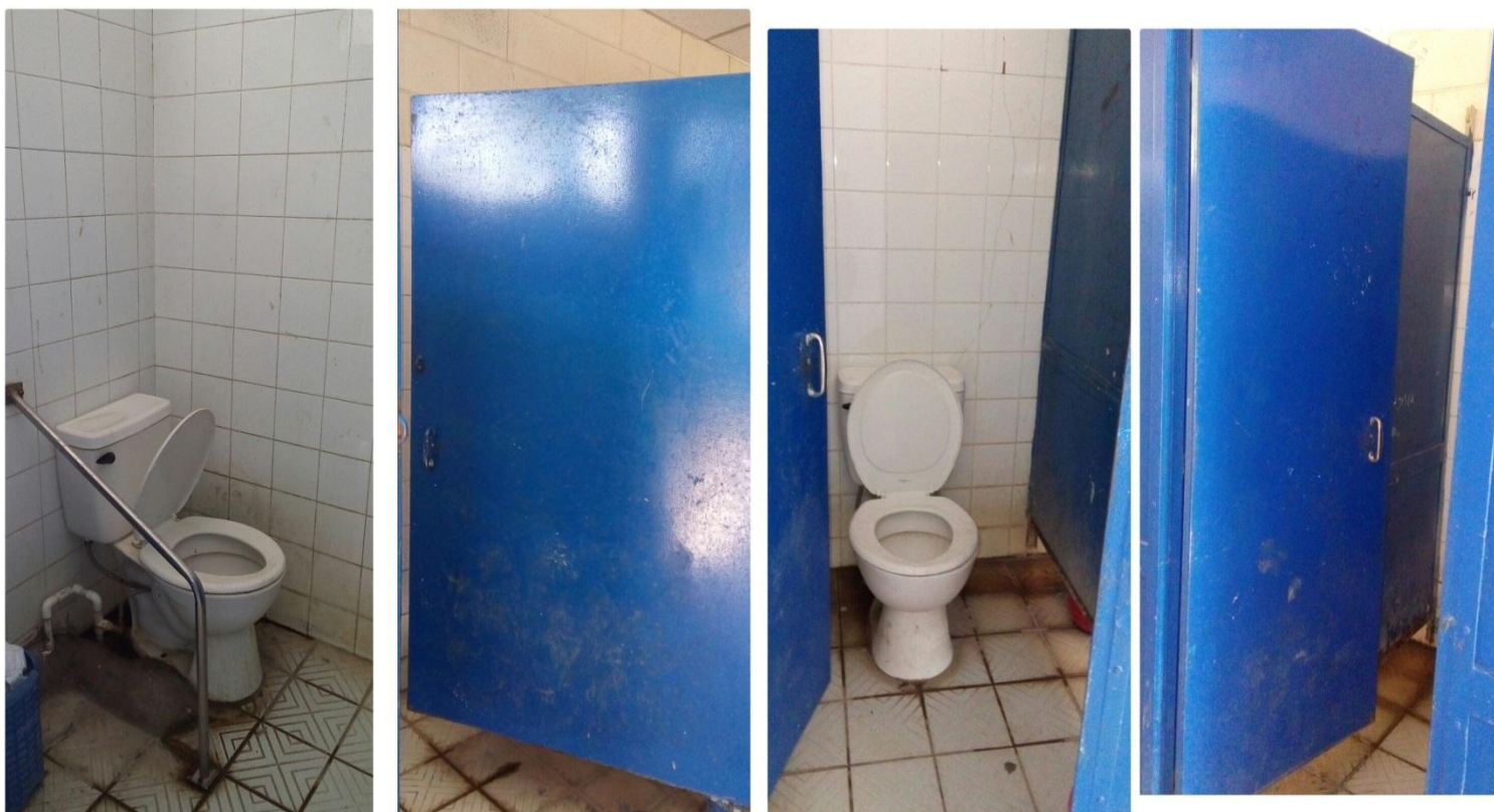
En la imagen presente, se muestra el baño de un centro educativo que tiene incorporado puerta amplia y pasamanos para niños/as con y sin necesidades especiales.
