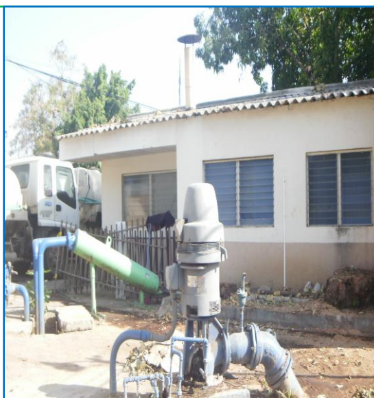
PLANTA DE BOMBEO EL JALACATAL
