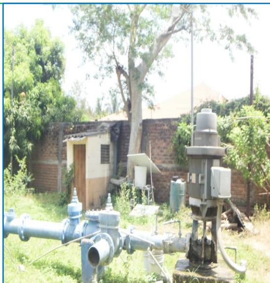
PLANTA DE BOMBEO EL SITIO I
