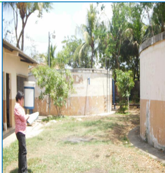
PLANTA DE BOMBEO RESIDENCIAL EL SITIO
