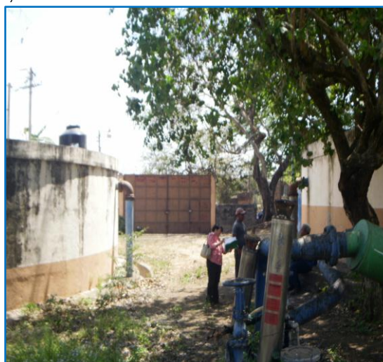
PLANTA DE BOMBEO LOMA DE CHAPARRASTIQUE
