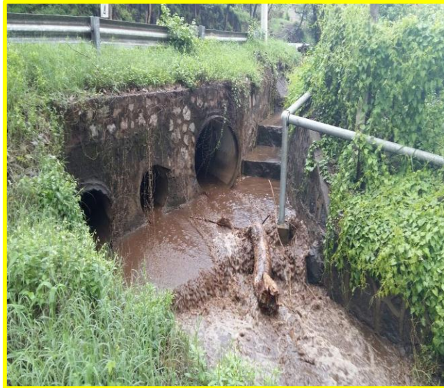
Figura 4.5 Desagüe descargando directamente al caserío El Conde Fuente: Grupo de estudio (2017)
