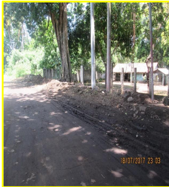
Figura 4.12 Ausencia de drenaje pluvial en la vía de acceso del caserío Fuente: Grupo de estudio (2017)
