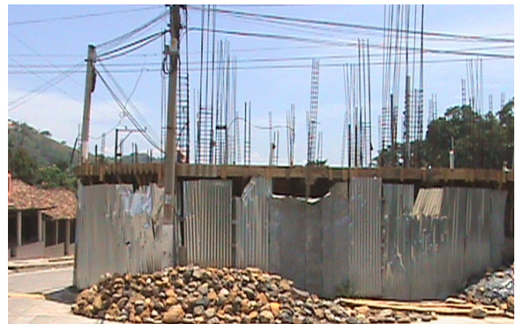
Construcción de casa de dos plantas en el casco urbano de Comalapa. Foto propia, tomada durante jornada de Observación No Participante. 5 de julio de 2009.
