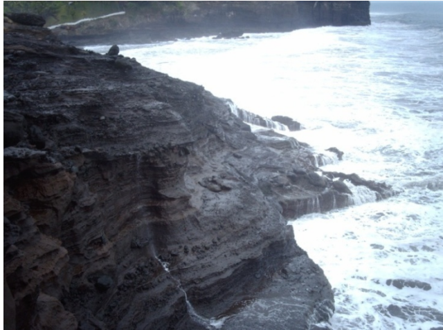
Fotografías 3-22b: Se muestran, la estabilidad del terreno en el Km 63 sobre la carretera El Litoral 209 .
