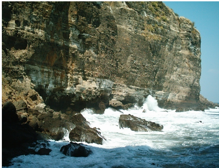
Fotografía 3-21a: Se muestra acantilados que presentan grietas que podrían dar lugar a futuras fallas 206 .
