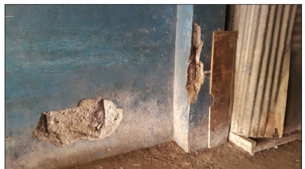
PAREDES INTERNAS DAÑADAS Debido a los incendios y a los sismos, la mayoría de las paredes internas están en mal estado.
