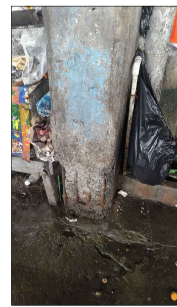
COLUMNAS DAÑADAS EN AREA INFERIOR El concreto explotado por la humedad e incendios
