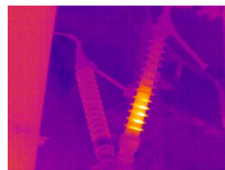
Estado de aisladores eléctricos
