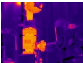
Pérdidas en válvulas
