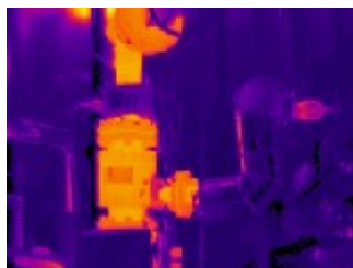
Perdidas en válvulas
