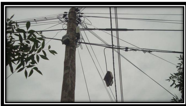
Imagen 19. Poste de Telecomunicaciones.
