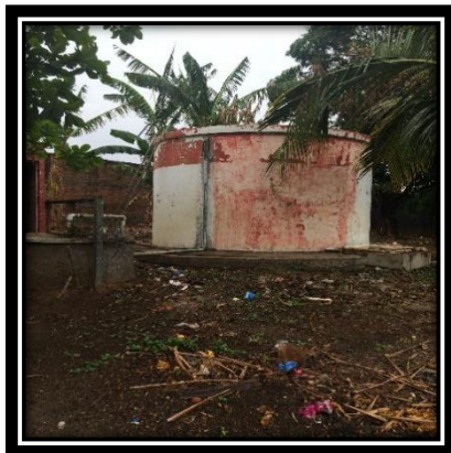
Imagen 17. Pozo y tanque.
