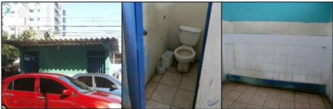
Servicios Sanitarios Deteriorados Figura 8 Fuente: Elaboración Propia
