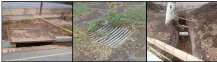
Aguas Lluvias Figura 18 Fuente: Elaboración Propia
