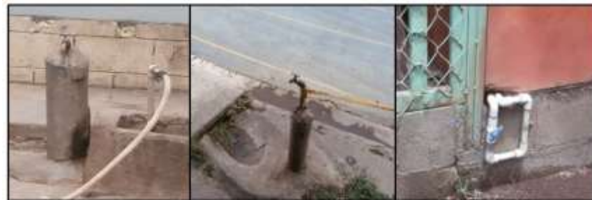
Suministro de Agua Potable Figura 16 Fuente: Elaboración Propia
