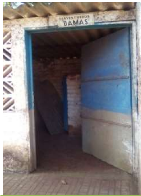
Infraestructura de Baños.
