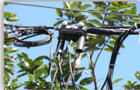
FOTO 15: SISTEMA DE TELEFONIA
