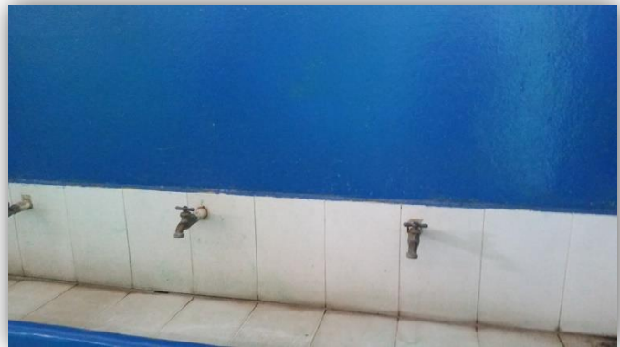
FOTO 13: GRIFOS AGUA POTABLE
