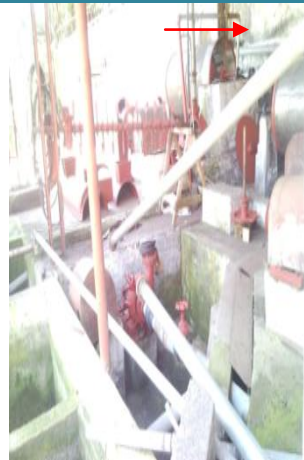
Foto 47. En la figura se observa que los elementos en mantenimiento estan en el piso no hay un lugar donde estos puedan ser almacenados correctamente mientras se
