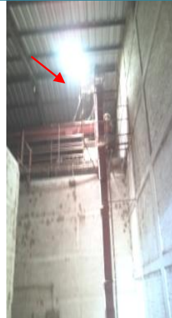
Foto 31. En el area de trojas se observa el gusano de trasporte del café sin proteccion ni senalizacion con franja amarilla que indique advertencia.
