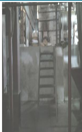
Foto 49. La escalera que une el area de secado con la bodega de pergamino no posee pasamanos, la contraguella es angosta
