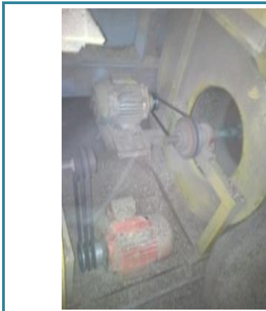
Foto 29. Se observa engrane sin proteccion ni senalizacion, en lugares cercanos al operario
