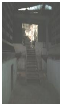
Foto 48. La escalera que une el area de hornos y calderas y las secadoras no posee pasamanos, la contraguella es angosta y puede propiciar caidas.
