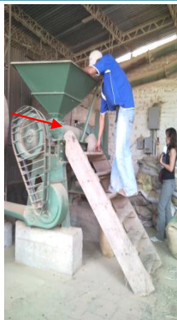
Foto 44. En la foto se puede observar que el operario debe vigilar el proceso desde la escalera que no es segura, ya que no posee barreras laterales, en la misma escalera suben con sacos de café para alimentar la maquinaria lo que contituye un riesgo aun mayor.
