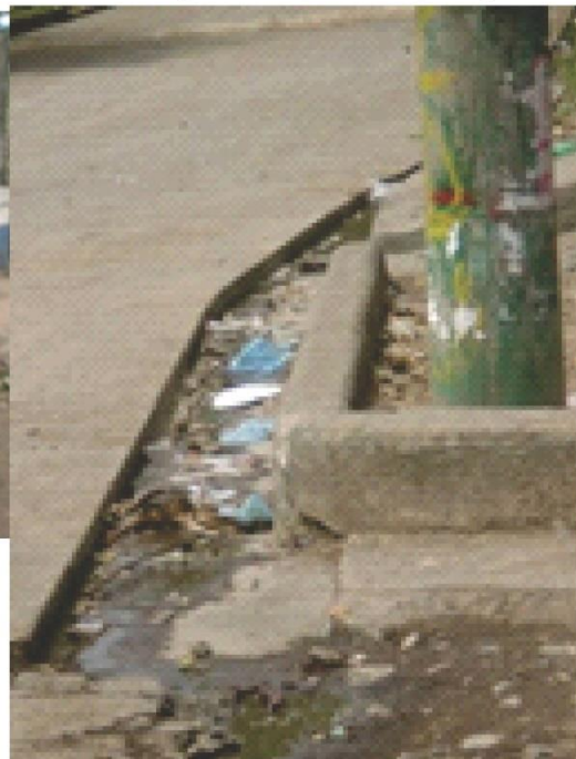
Cuneta "El Obrajuelo"
