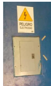
Imagen 35: Tablero de instalaciones eléctricas dentro del Centro de Formación Integral para Hombres.
