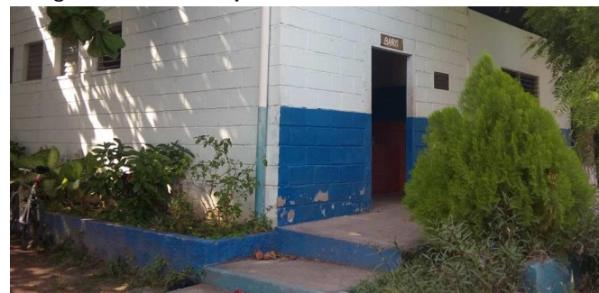
Imagen 36: Falta rampas de acceso a servicios sanitarios
