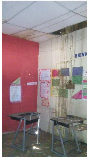
Imagen 59: Lesión física por humedad de filtración
