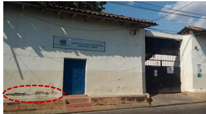
Imagen 60: Lesión física por erosión de agua, sol y viento en fachada
