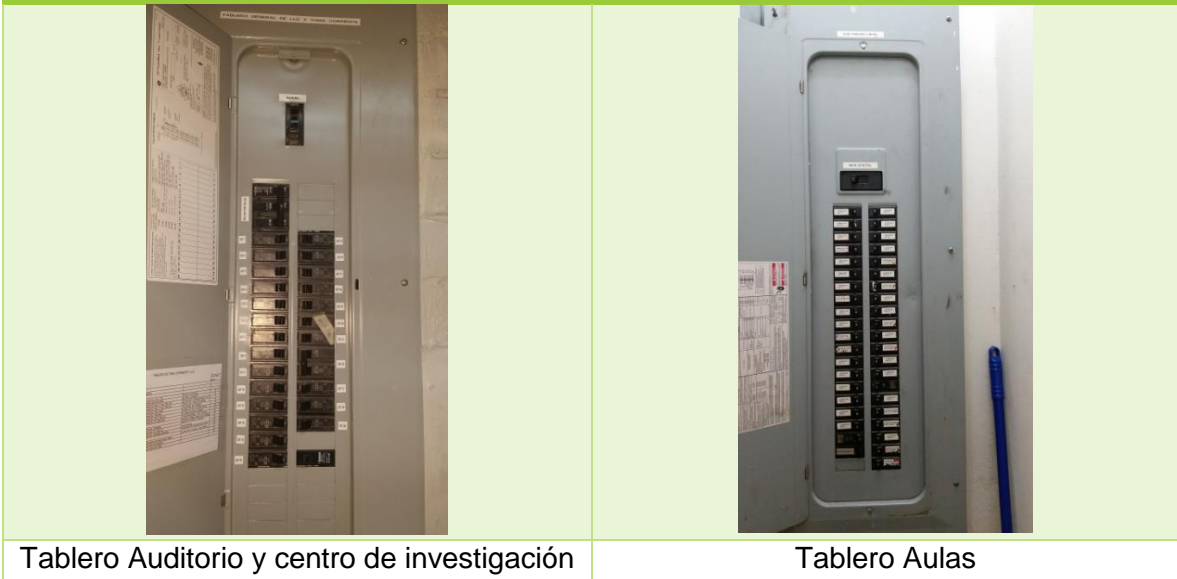
Ilustración 117: Fotografías de tableros eléctricos aulas y auditorio
