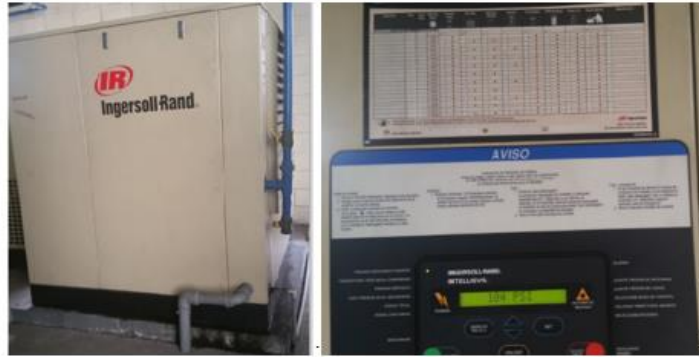
Ilustración 85 Ilustración 96 Sistema de compresión Ingersoll Rand
