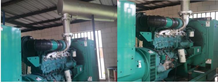
Planta de emergencia
