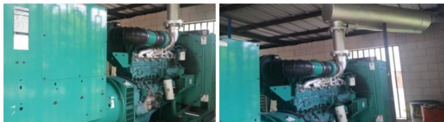
Ilustración 84 Planta de emergencia Cummings modelo 275 DFBF-3777
