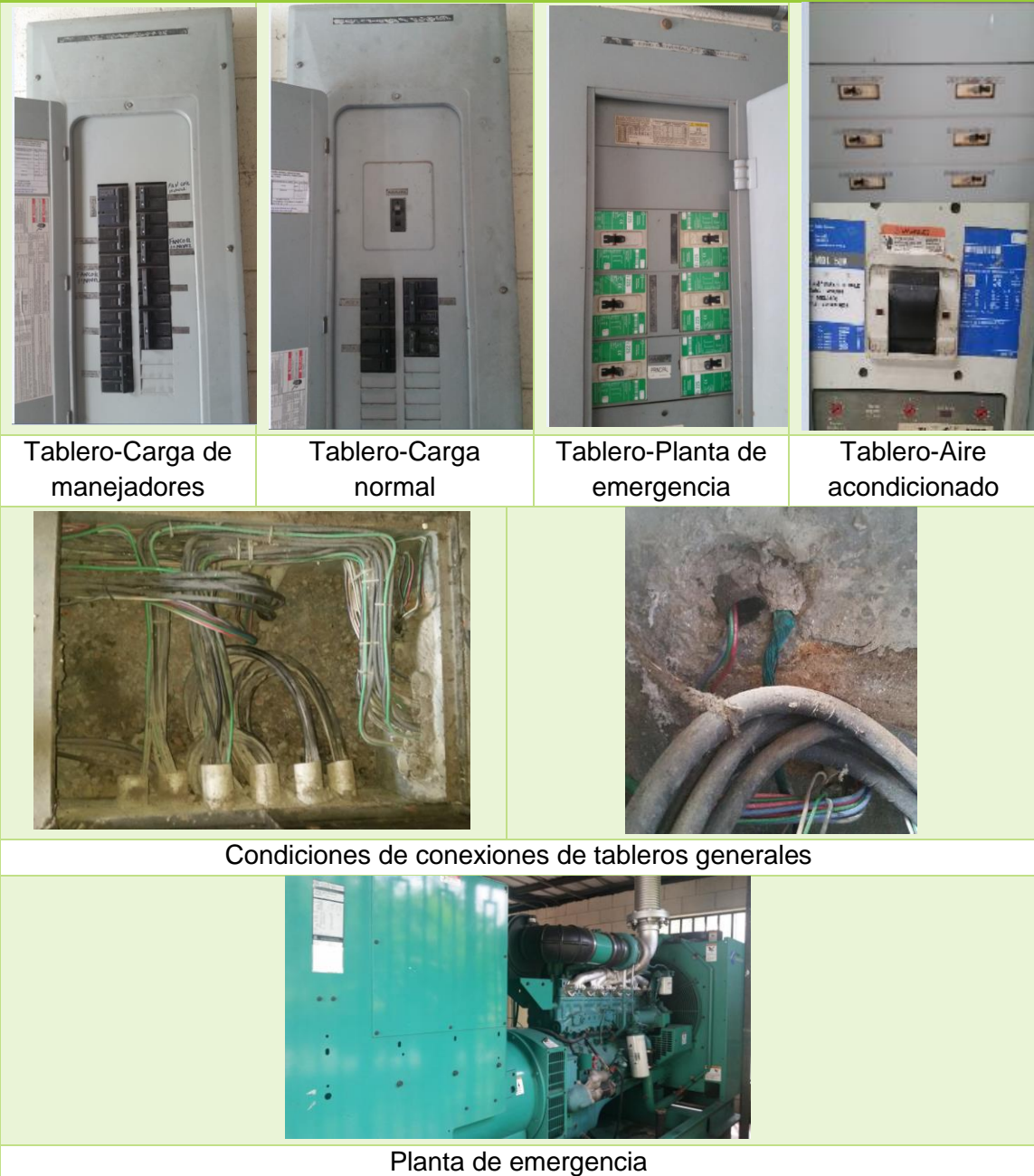
Ilustración 116: Fotografías de tableros generales y plantas de emergencia exteriores
