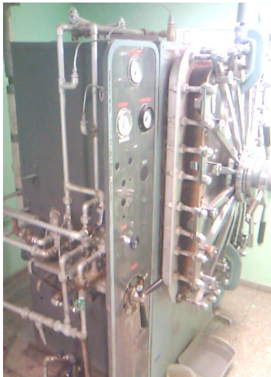
Fotografía 14. Autoclave Hirayama. Presenta fuga de vapor en la puerta que se condensa y escurre hasta los depósitos colocados al pie
