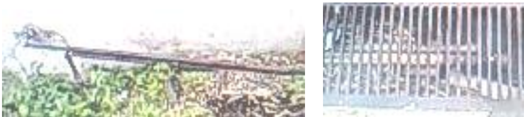
Fotografías 31 y 32. Segmento de tubería de retorno de condensado proveniente de la sección de Alimentación y Dietas completamente expuesto a la atmósfera
