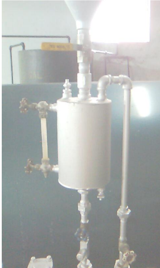
Fotografía 51. Dosificador de productos químicos para el tratamiento interno del agua de alimentación.
