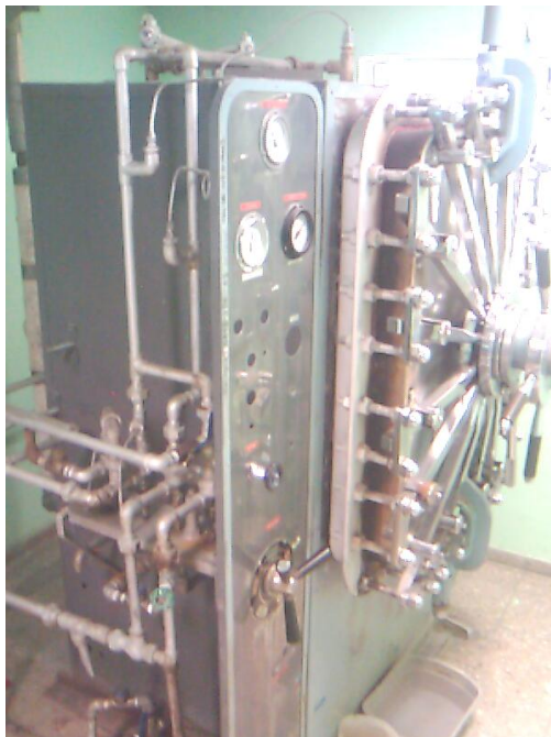
Fotografía 3. Autoclave marca Hirayama Mantiene dos depósitos abiertos al pie para coleccionar el condensado que fuga la puerta
