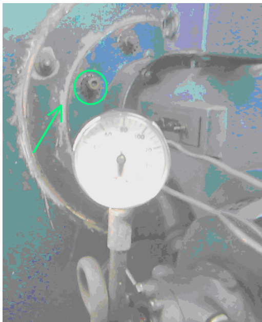
Fotografía 42. Ensamble del quemador a la caldera No 1. El círculo muestra un perno suelto y la flecha indica un punto de fuga de gases calientes
