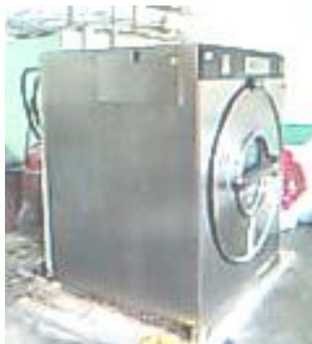
Fotografía 20. Lavadora automática marca Girbau en mal estado. Controlada como lavadora 1 en figura 5
