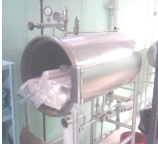
Fotografía 1. Autoclave marca Castle en desuso por falta de puerta
