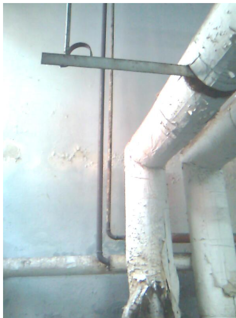
Fotografía 47. Tubería de vapor y condensado de arsenal quirúrgico, al fondo. Nótese su falta de aislamiento
