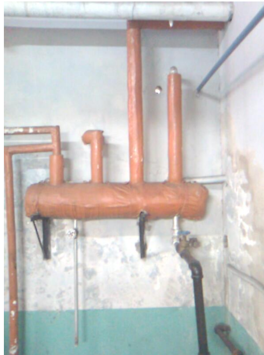
Fotografía 48. Tanque de vaporización instantánea del sistema de retorno de condensado. Se encuentra bien aislado térmicamente
