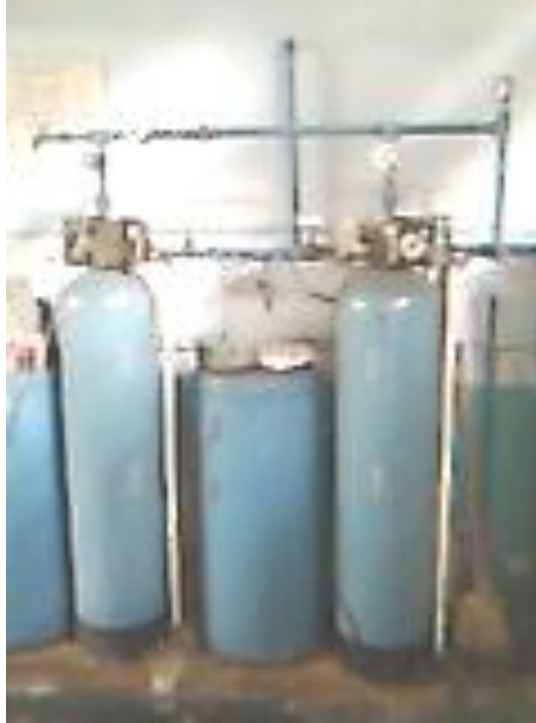
Fotografía 50. Sistema de suavización de agua
