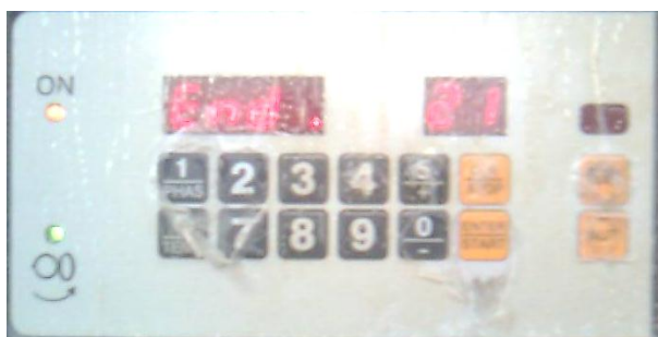
Fotografía 22. Tablero de control de las lavadoras automáticas Girbau
