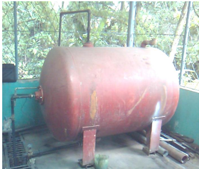
Fotografía 49. Tanque de mezcla de condensados y agua suave
