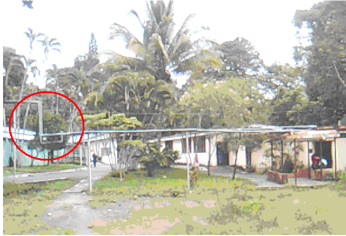
Fotografía 30. Tramo de tubería de vapor y retorno de condensado que cruza sobre el predio que ocupara un edificio que fue demolido. Nótese la deflexión vertical señalada por el círculo rojo
