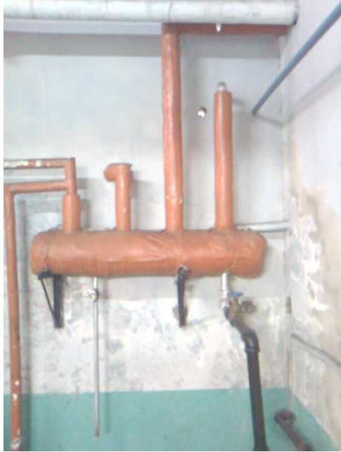
Fotografía 35. Tanque de vaporización instantánea del sistema de retorno de condensados
