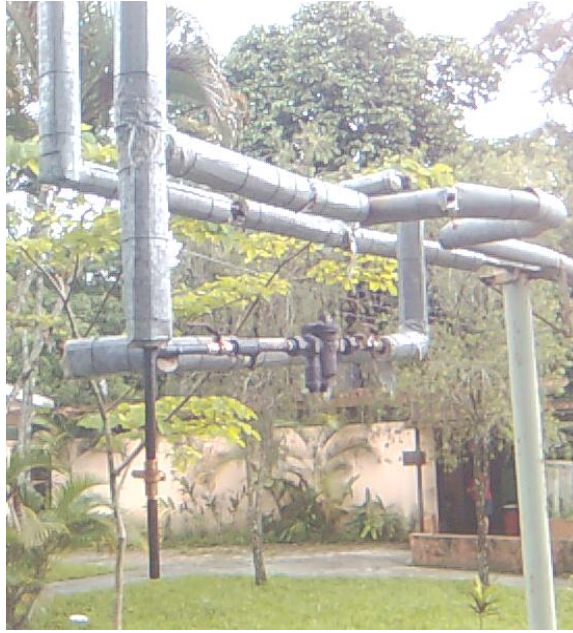
Fotografía 36. Trampa 6 de la línea de vapor y junta de extensión en forma de U Se observan puntos de tubería descubiertas entre tramos de aislante
