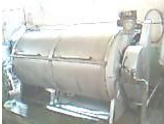
Fotografía 7. Lavadora No.3, lavadora horizontal marca Oñate
