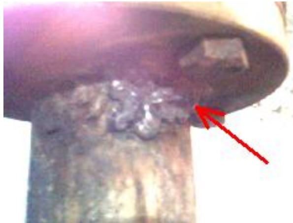
Fotografía 46. Zona de la derivación ciega del cabezal de vapor que presenta varios puntos de fuga
