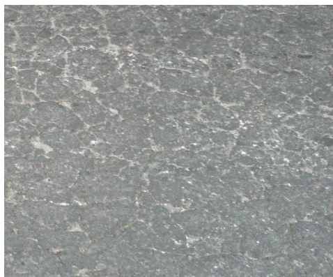
FIGURA 4.7 – Fisura Piel de Cocodrilo Fuente: Fotografía Tomada en Colonia Villa Lourdes, Lourdes Colón.
