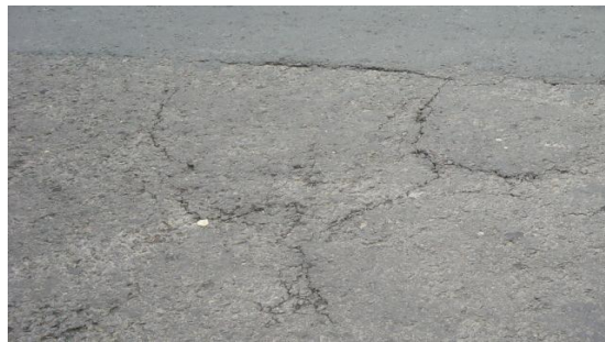
FIGURA 4.6 – Fisura en bloque
