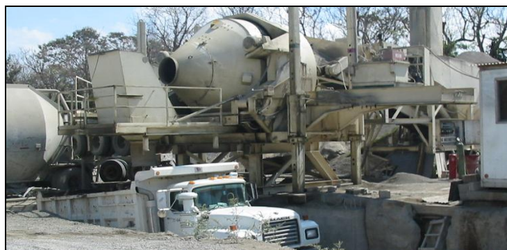
Ilustración 32 - Planta portátil utilizada en el proyecto de reconstrucción de la carretera de San Martín a San Rafael Cedros.
