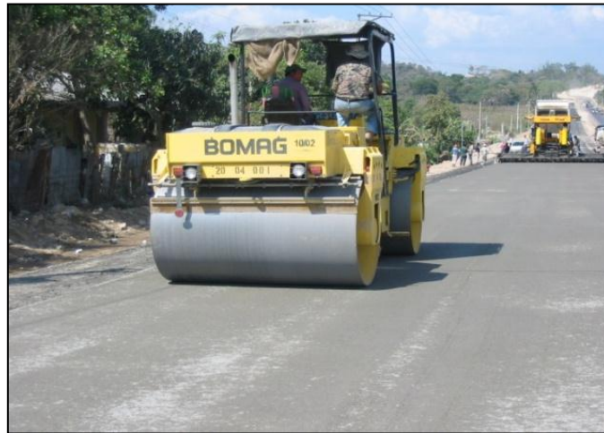
Ilustración 37 - Equipo de compactación rodillo liso sin vibración.
