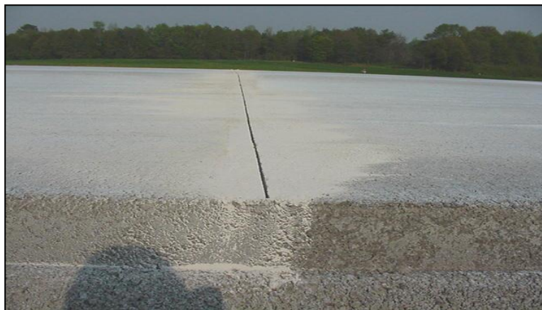
Ilustración 39 - Vista de Junta Transversal en el pavimento.
