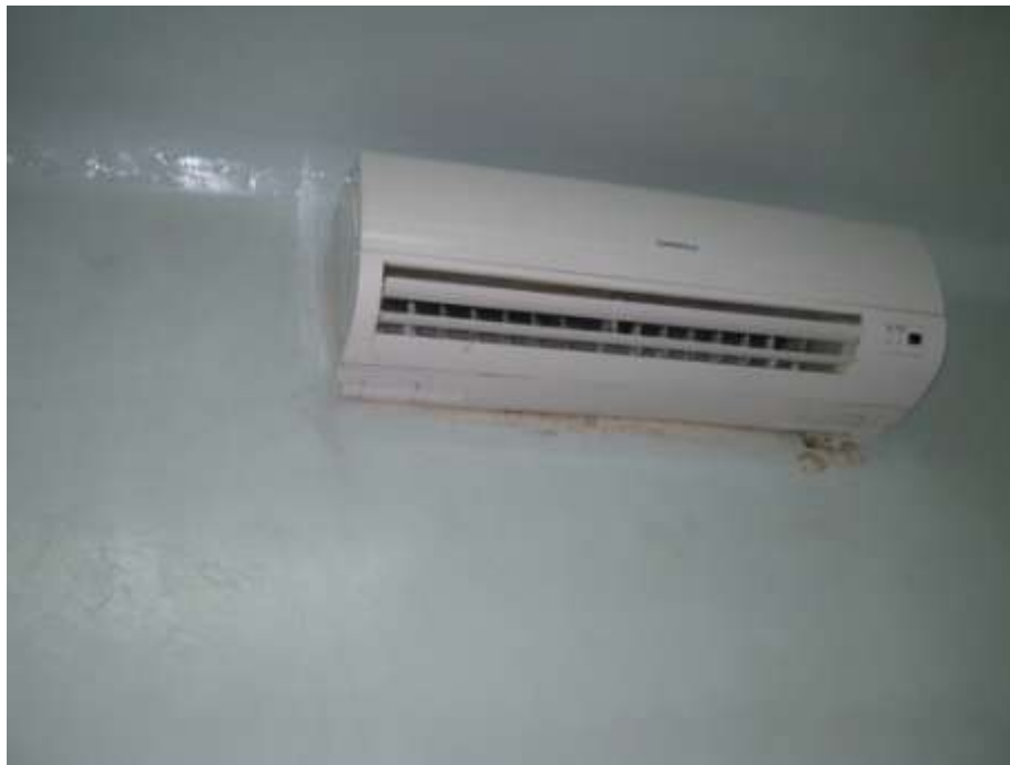
Figura N o 9. Aire acondicionado (área blanca)
