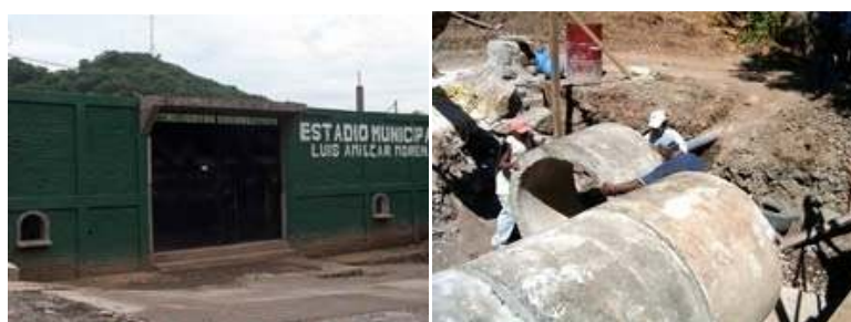
Remodelación del Estadio Municipal. Construcción de obra de paso caserio lo segura, canton cacahuatalejo
