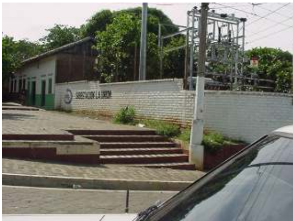
Subestación La Unión
