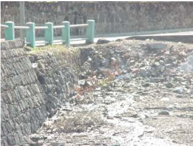
Descarga de aguas negras 7°av. Norte Balneario la Rabida
