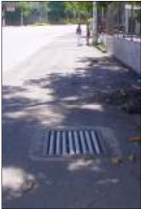
Tragantes Aguas Lluvias
