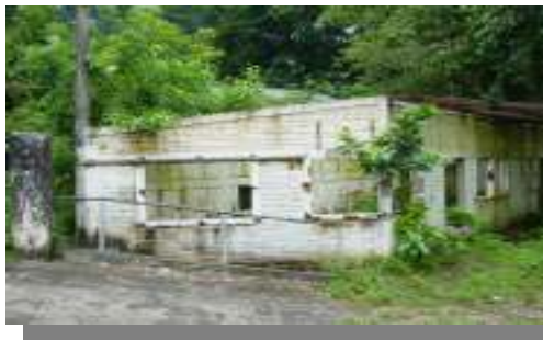
edificación anteriormente era utilizada como Parte del área administrativa que conformaba parte del beneficio San Emilio
