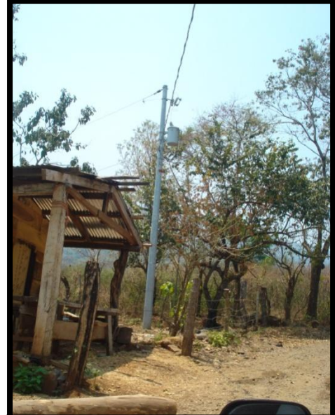
Fotografía III. 15 Vista de servicio eléctrico.
