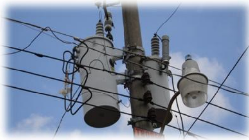
Fotografía N° 7 Red de Energía Eléctrica
