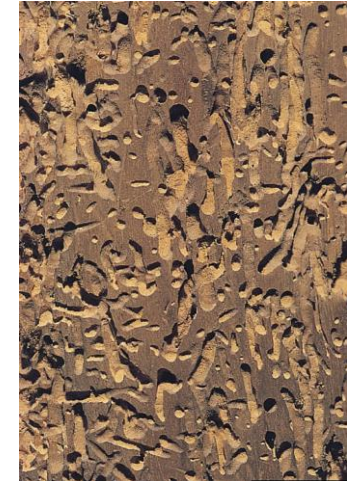
Detalle de madera dañada por insectos xilófagos, flechas y orificios
