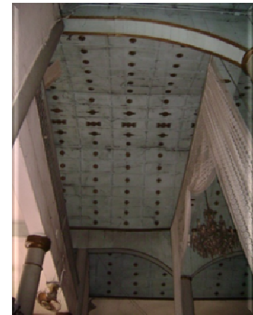
Fig. 43. Cielo Falso en Nave Central,
