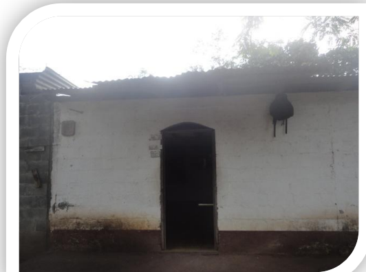
Imagen 146: El estado de las paredes es bastante deteriorado
