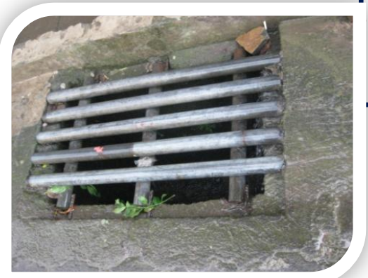
Imagen 67: tragante de aguas lluvias Fuente: propia
