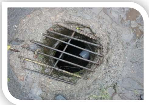
Imagen 75: tragante de aguas lluvias Fuente: propia
