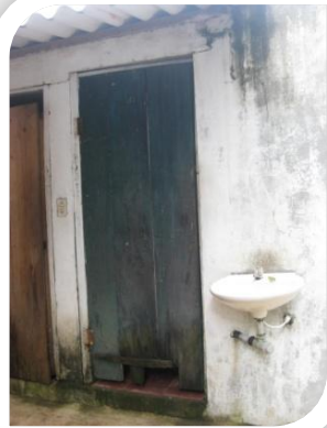
Imagen1: puertas en mal estado del museo Fuente: Pronia
