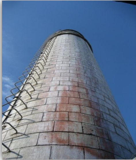
Fig.: 10 Elemento Arquitectónico Ubicado en el Área de Carnes
