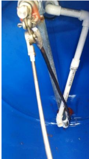
Figura 70: Tubería interna al tanque de transporte de agua de la salida del colector. (2018). [Fotografía]. Fuente: Los Autores
