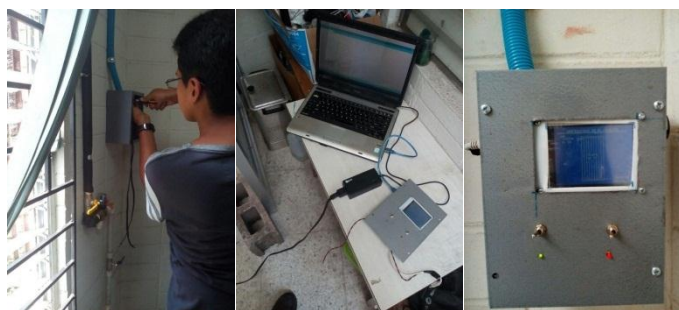
Figura 61: Instalación sistema de monitoreo. (2018). [Fotografía]. Fuente: Los autores.
