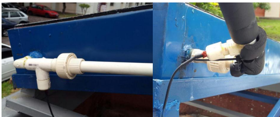
Figura 64: Sensores a la entrada y salida del colector solar. (2018). [Fotografía]. Fuente: Los autores.
