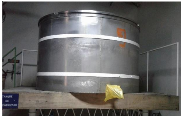
Figura N° 14 Tanque de Homogenización
