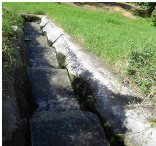
Figura 7. Gradadas de aireación de la PTAR de San Luis Talpa.
