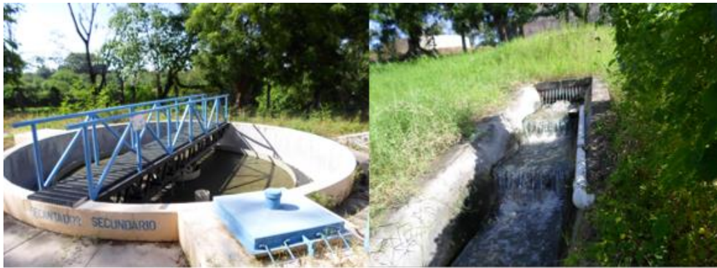
Figura 11. Decantador secundario y gradas de aireación.
