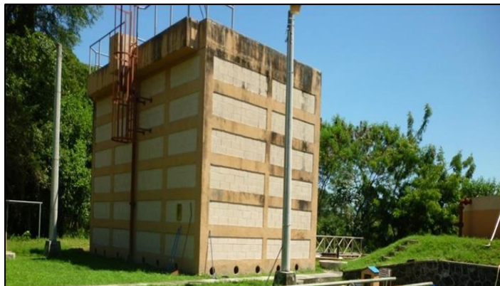
Figura 5. Filtro biológico de la PTAR de San Luis Talpa.
