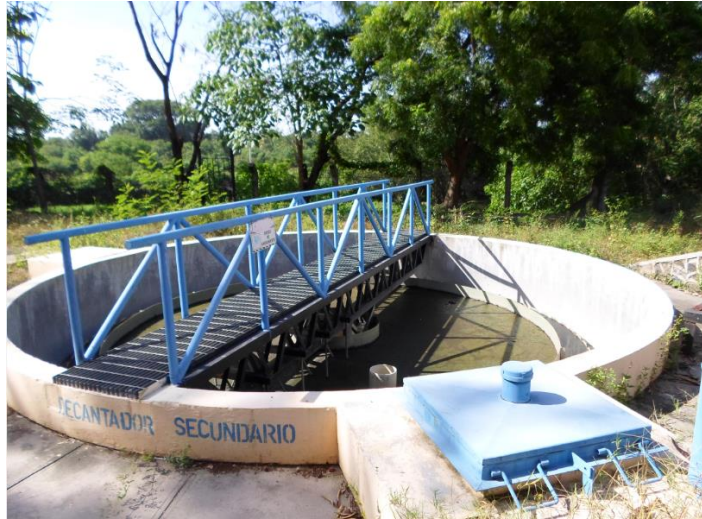
Figura 6. Decantador secundario de la PTAR de San Luis Talpa.
