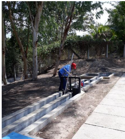
Figura 3. Rejilla, desarenador y canaleta Parshall de la PTAR de San Luis Talpa.
