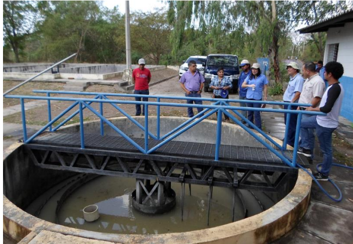
Figura 4. Decantador primario en la PTAR de San Luis Talpa.
