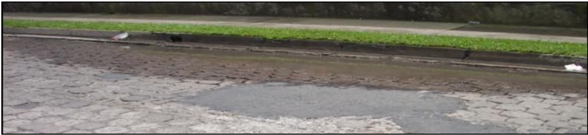
Figura 40: foto de estado de calle y aguas lluvias retenidas
