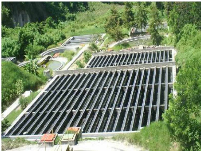
Figura 2.3.6. Filtro percolador cuadrado.
