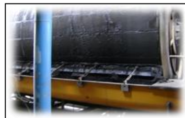
Ilustración 9. Filtros de cachaza
