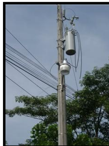
Foto N° 27 poste de servicio de energía eléctrica y alumbrado público
