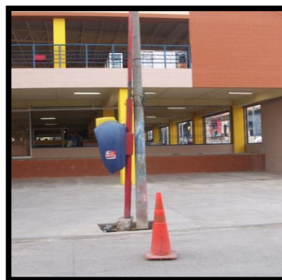
Foto N° 26. Caseta telefónica ubicada en el mercado municipal
