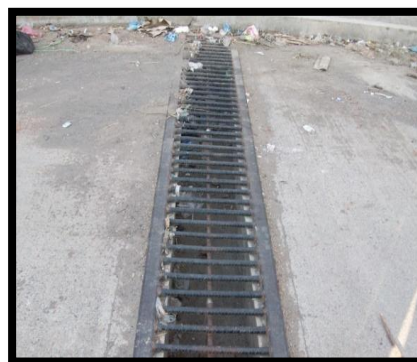
Foto N° 25. Detalle de alcantarillado de aguas lluvias.
