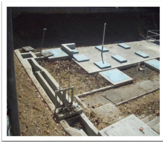
Fig. 30 Planta de Tratamiento de Aguas Residuales.
