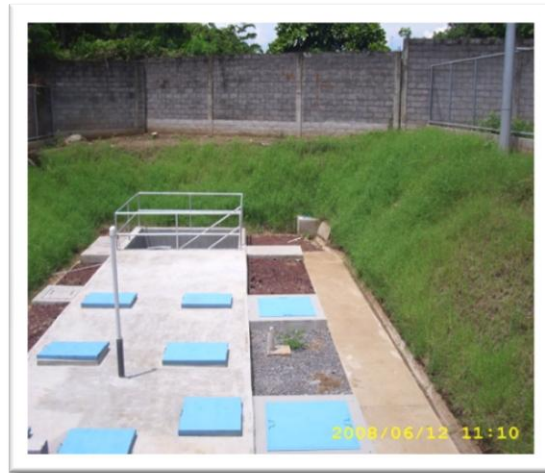
Fig. 31 Planta de Tratamiento de Aguas Residuales.
