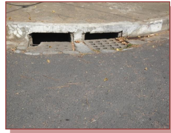
Fig. 22. Alcantarillado de aguas lluvias.
