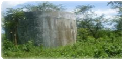
Fotografía N°35 Tanque de almacenamiento de la red de agua potable.
