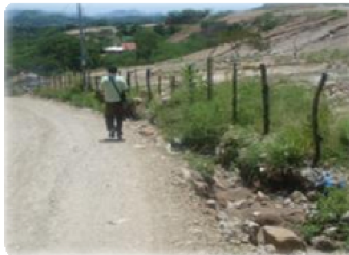
Fotografía N° 41 Drenaje de Aguas Lluvias en el área Rural por Cordón cuneta de tierra.
