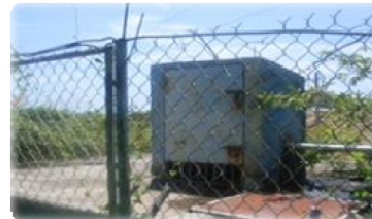
Fotografía N°36 Bomba de suministro de agua potable.
