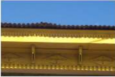
Detalle del remate del inmueble , el cual presenta ménsulas talladas en madera
