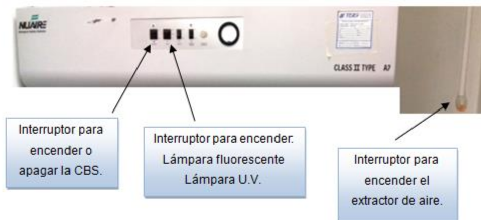
Figura N° 14 Panel de Control de la Cabina de Flujo Laminar del Centro Médico.
