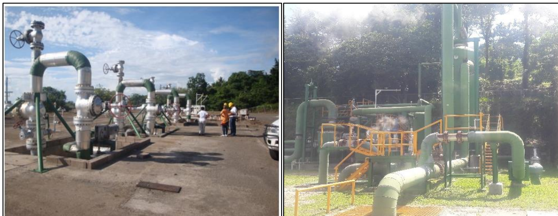
Figura 6. Equipos superficiales instalados en una plataforma geotérmica. (Fuente: Flamenco, 2018)
