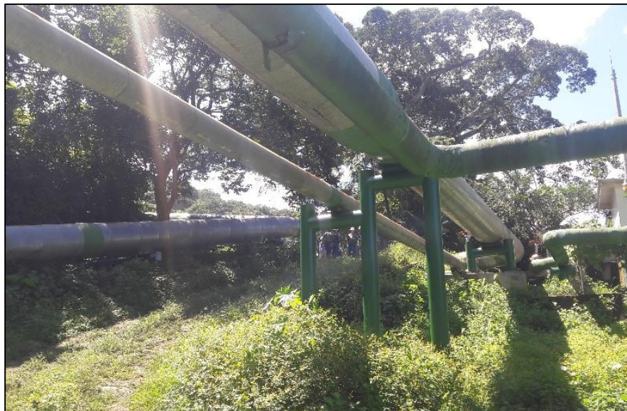
Figura 9. Líneas de acarreo de flujo vapor y salmuera. (Fuente: Elaboración Propia, 2018)
