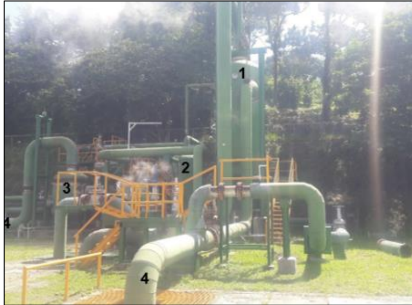
Figura 8. Equipos superficiales en plataforma de separación 1) Separador ciclónico; 2) Tanque de agua; 3) Tanque de bola; 4) Líneas de acarreo (Fuente: Flamenco, 2018)
