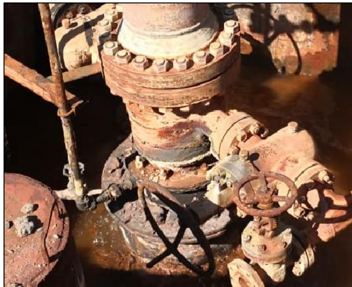
Figura 27. Daños en equipos superficiales y tubería conductora (Fuente: Polaris, 2018).
