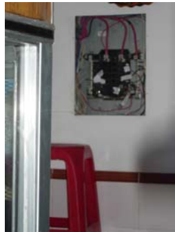
Fotografía 7. Condiciones inseguras en las instalaciones
