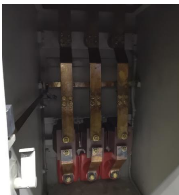
Figura 8. barras eléctricas de media tensión expuestas durante una operación de mantenimiento mayor.
