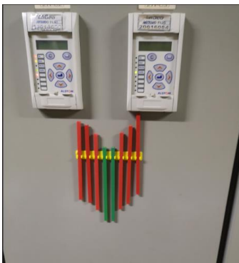
Figura 6. dispositivos de bloqueo de interruptores de baja tensión actualmente utilizados en la planta.
