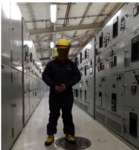
Figura 7. EPP para arco eléctrico actualmente utilizado en la planta.
