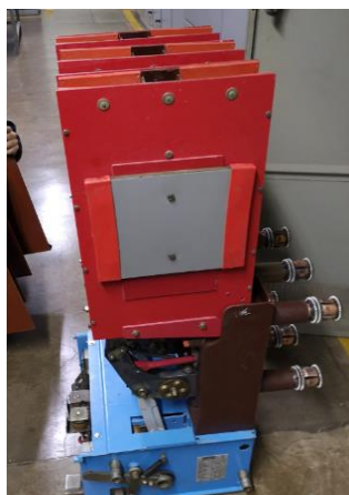
Figura 10 interruptor eléctrico de media tensión extraído durante pruebas de mantenimiento.
